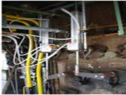
Nuovi servomotori custom per registri aria combustione
