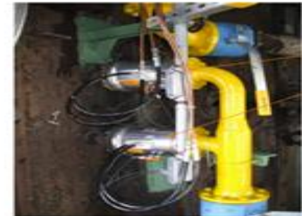
Nuove valvole automatiche gas metano
