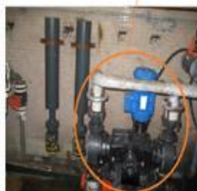
Nuovo skid di dosaggio acido
