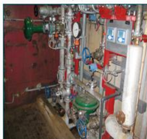
Nuovo skid di miscelazione strumenti analisi – valvole di regolazione
